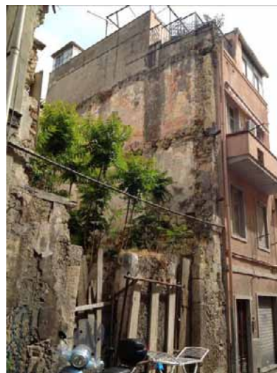
Figure 2 : Éboulement historique rue Piccioni
